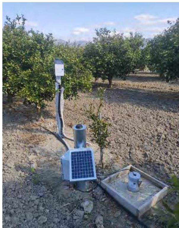
Slika 6. Višeparametarska sonda za praćenje zaslanjenosti podzemnih voda instalirana u piezometru
