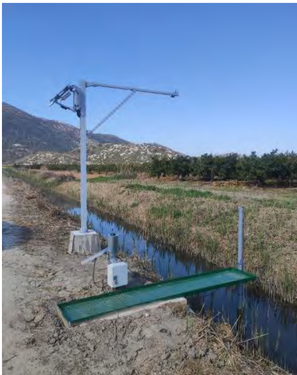
Slika 7. Beskontaktni radarski sustav za praćenje površinske brzine i razine vode u otvorenim vodotocima
