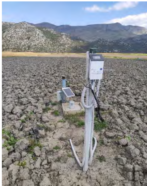
Slika 3. Višeparametarska sonda za praćenje zaslanjenosti podzemnih voda instalirana u piezometru
